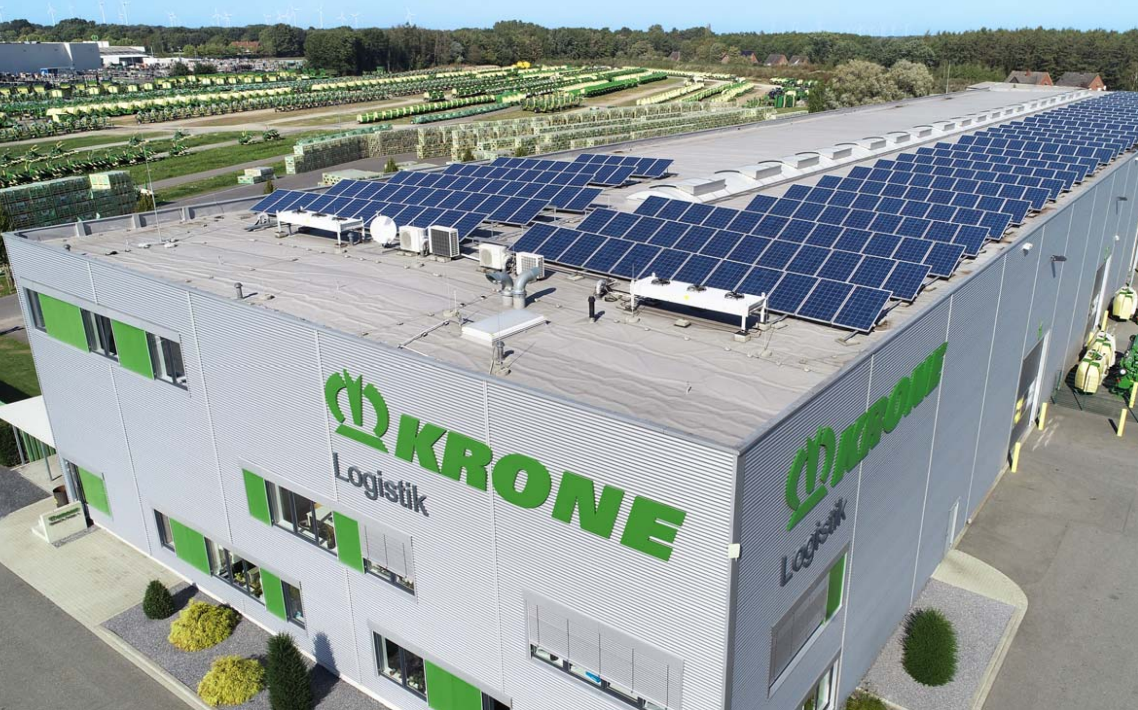
Mehr als 400 Photovoltaikmodule auf dem Dach des Logistikzentrums.
